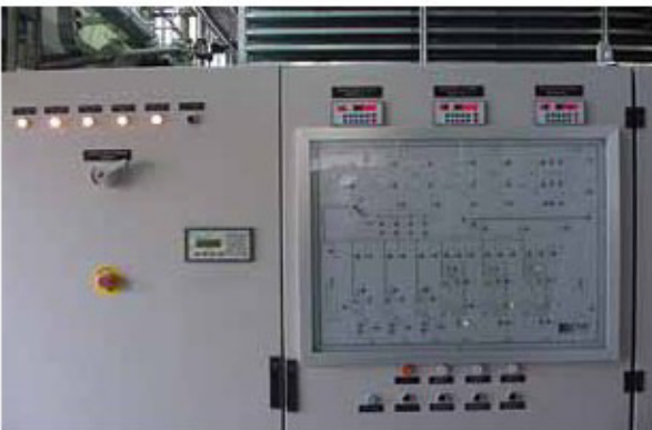
Control de produção mediante PLC
